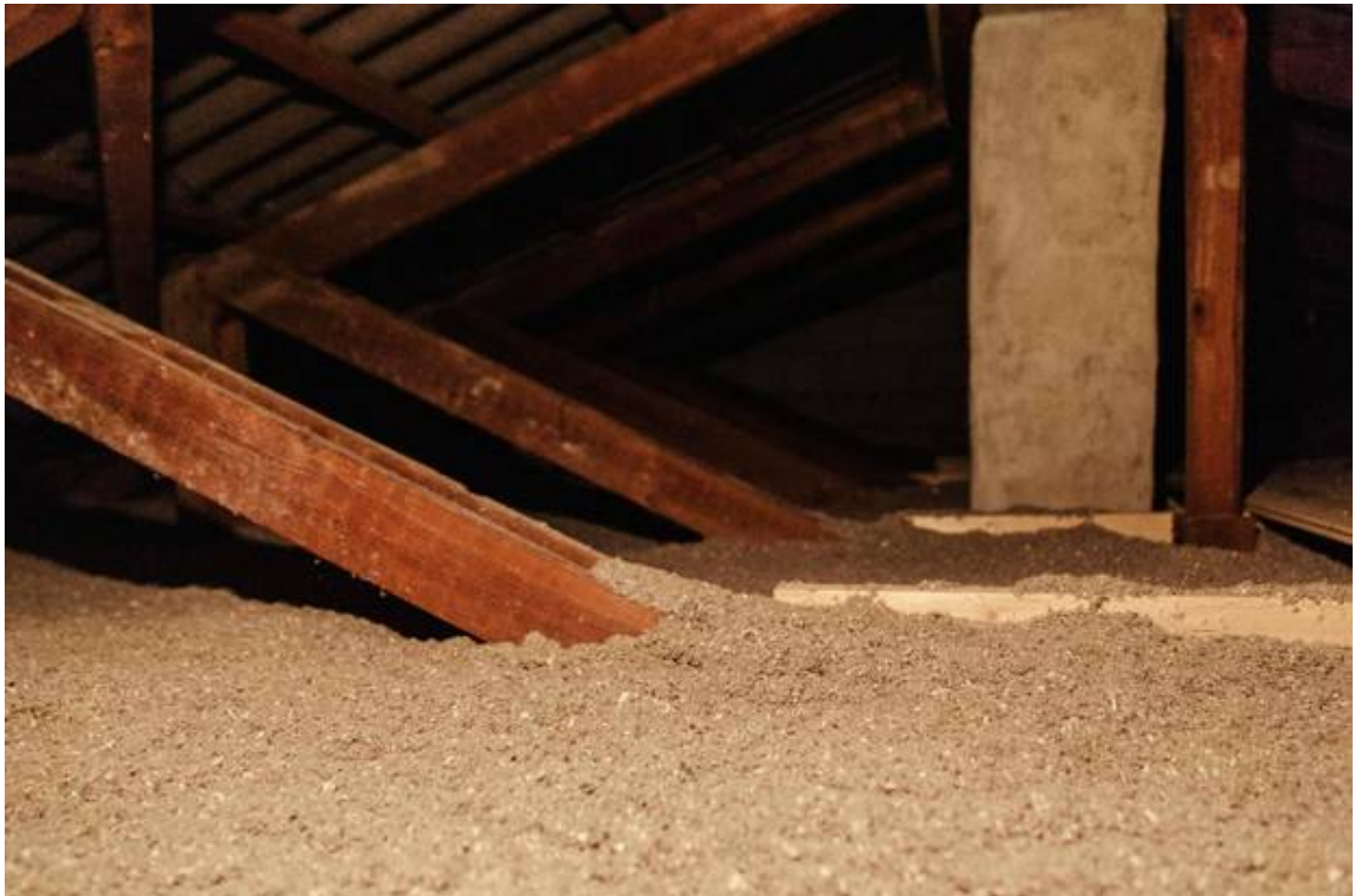
På loftet ligger et tykt lag af isolerende papiruld. Dette var familiens første energiforbedrende renovering. Foto: Kristoffer Juel Poulsen
